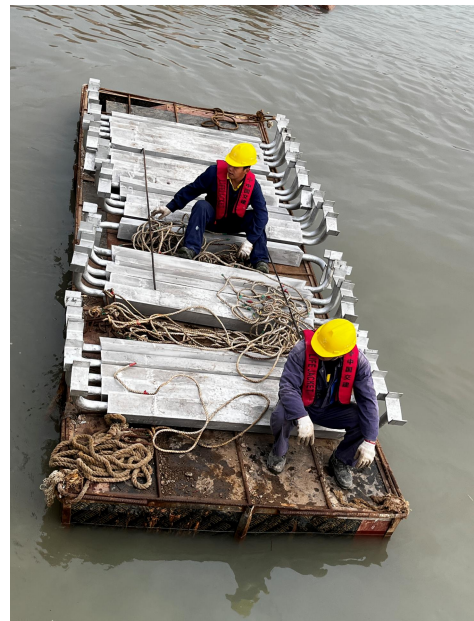
深圳机场三跑道扩建工程场地 陆域形成及软基处理工程牺牲 阳极施工
